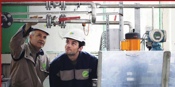
Foto aus lyonnaise-des-eaux.com
